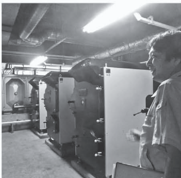
温泉施設に薪ボイラー利用
