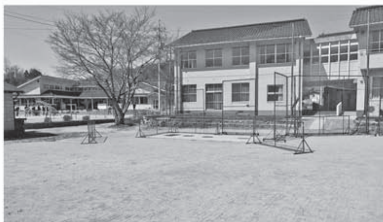
伊尾スポーツ広場に設置された浄化槽
