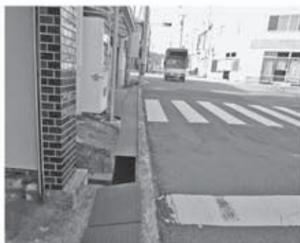
市尻交差点付近の未整備側溝
