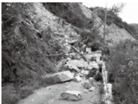
豪雨により被災した町道井庄原小谷線
