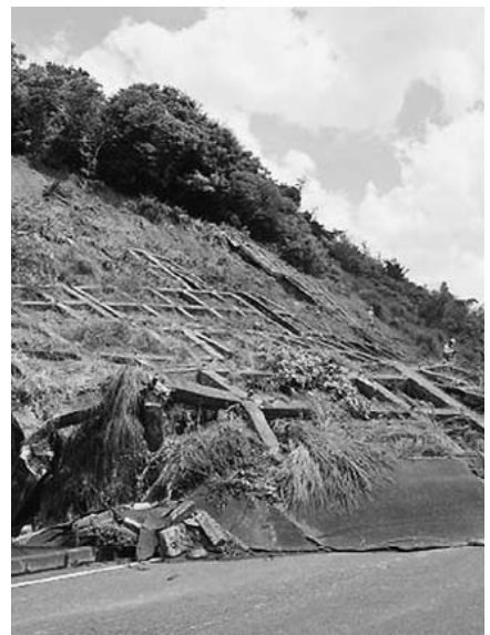
フルーツロード豪雨災害現場
