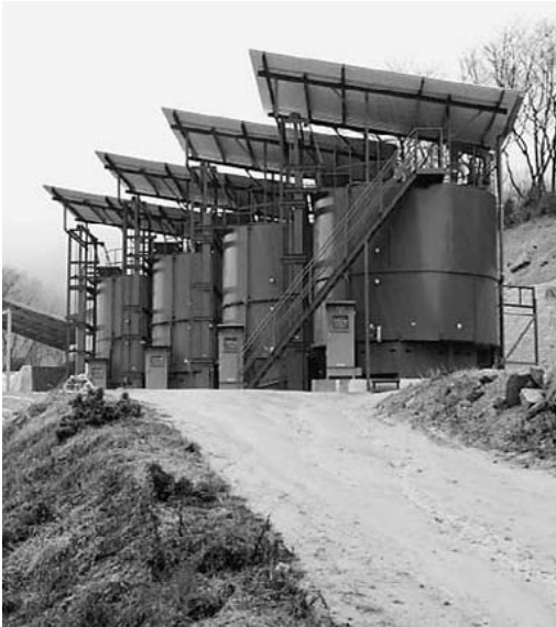
新設されている臭気対策施設
