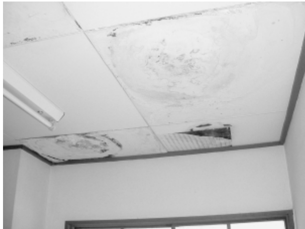
老朽化が進む 伊尾公民館
