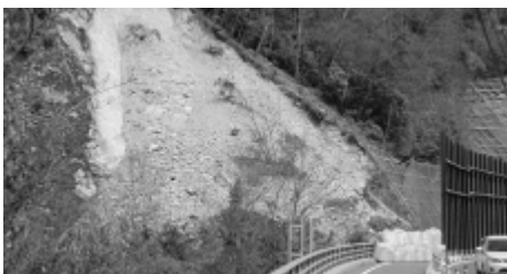
小谷の崩落現場
