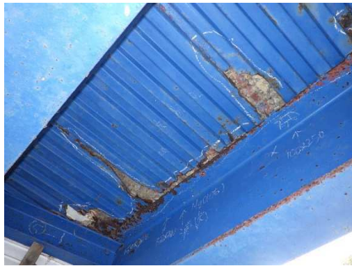
鋼床版の腐食・欠損
