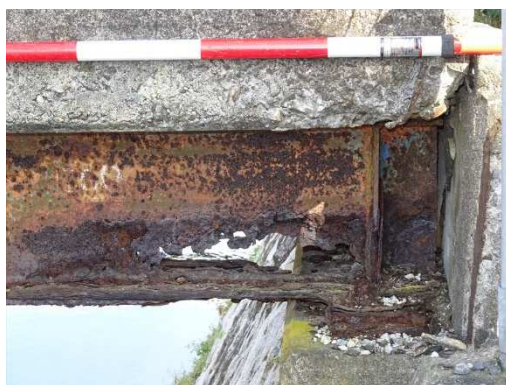
主桁の腐食・防食機能の劣化
