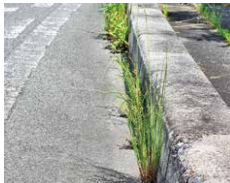
昨年土砂撤去が行われた町道三原中島線
