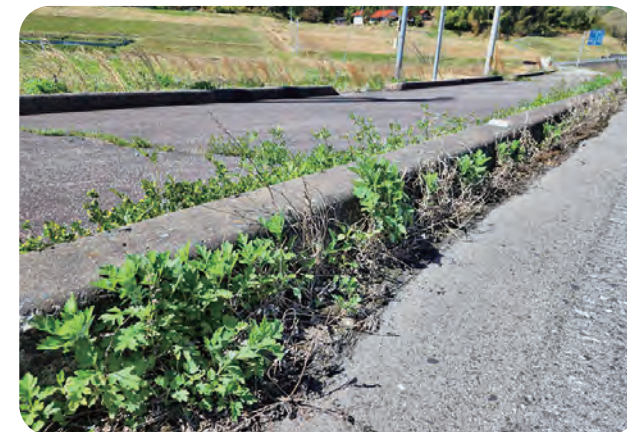
縁石に溜まった土砂
