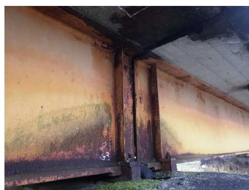
主桁の腐食・防食機能の劣化
