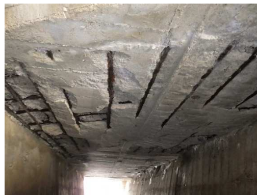
コンクリート床版の鉄筋露出
