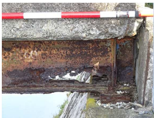
主桁の腐食・防食機能の劣化
