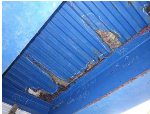
鋼床版の腐食・欠損
