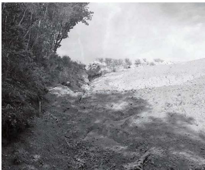
土砂災害特別警戒区域上流部の危険な盛土
